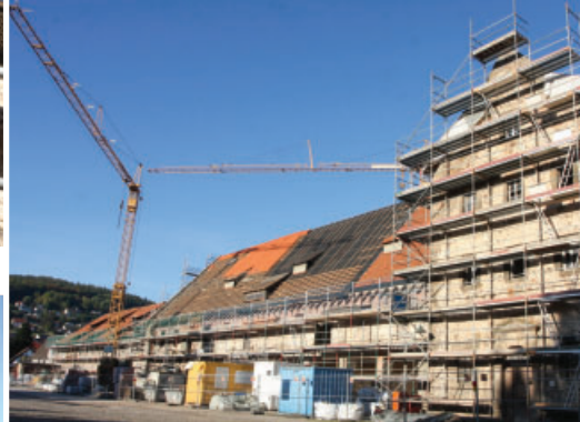
Die eingerüsteten alten Wirtschaftsgebäude der Domäne
